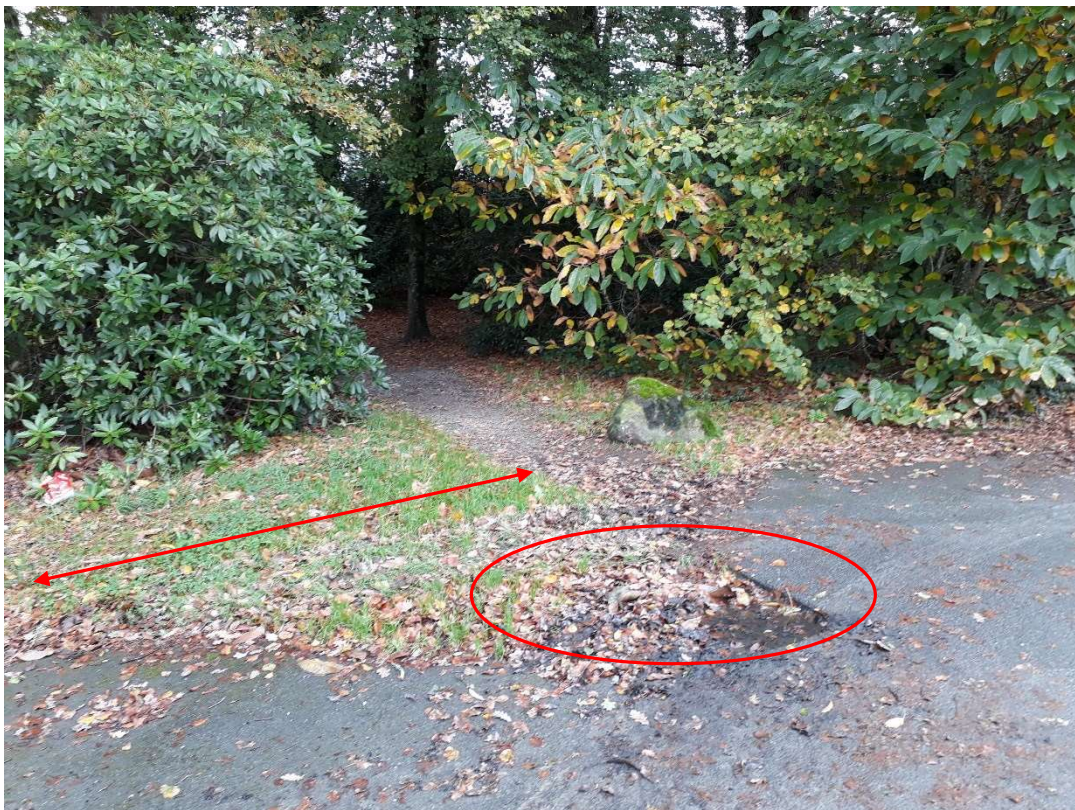
Absence de trottoir le long du stade (entre le parc et les entrées du stade) et mauvais état du revêtement de la voie au débouché du 2 nd sentier du parc.
