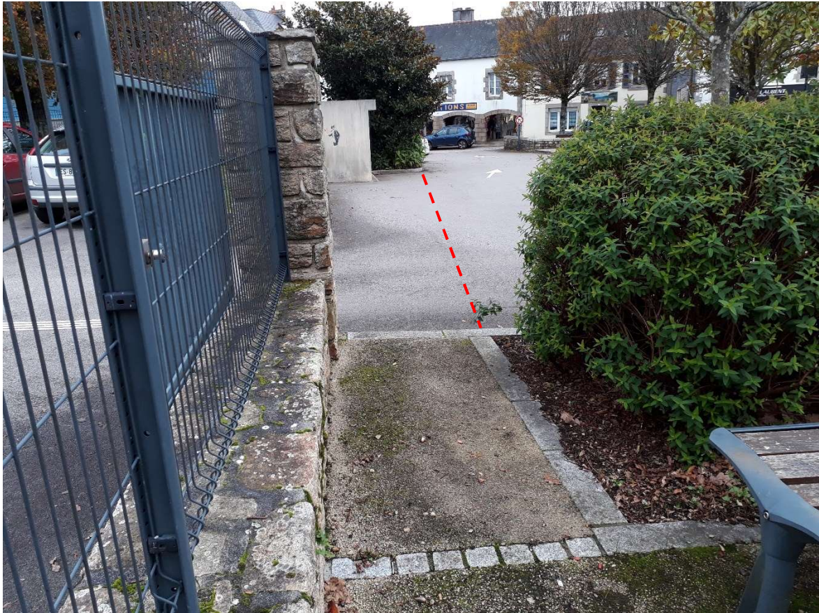
Défaut de matérialisation du cheminement piétons/PMR à la sortie de l'école (vers voie douce)
